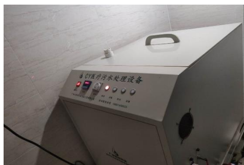
医疗废水处理设施（臭氧发生器）
