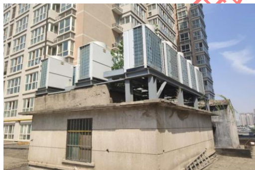
中央空调机组
