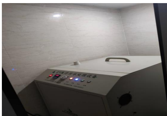
医疗废水处理设施
