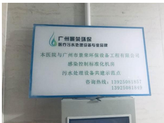
医疗废水处理设施
