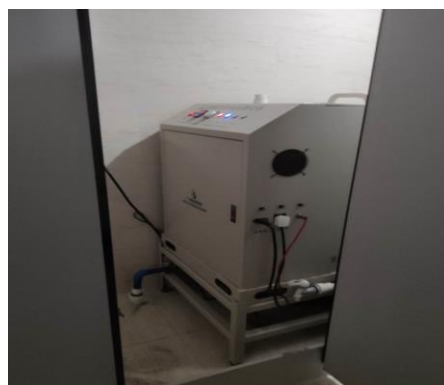
医疗废水处理设施
