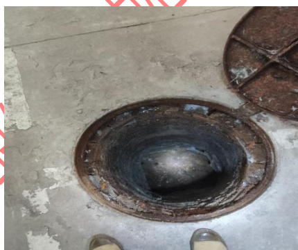
小区总化粪池
