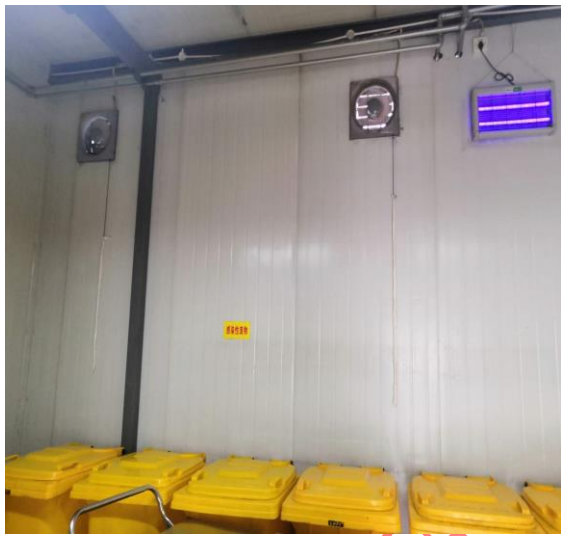
医疗废物暂存间消毒及通风设施
