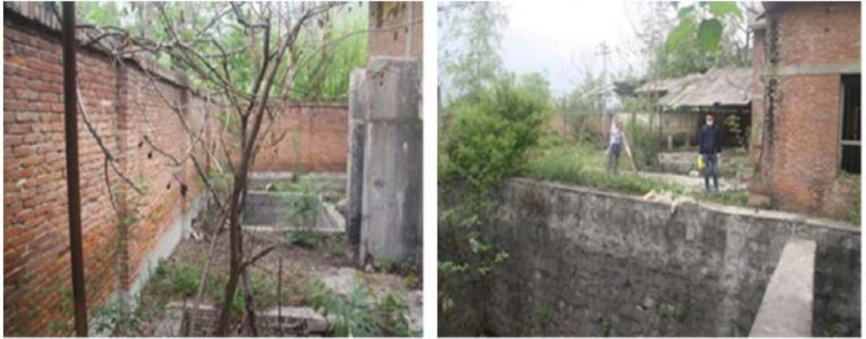
照片 9-2 治理前生产厂区内水泥池现状照片
