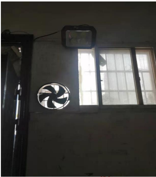
危废间排风扇及防爆照明灯
