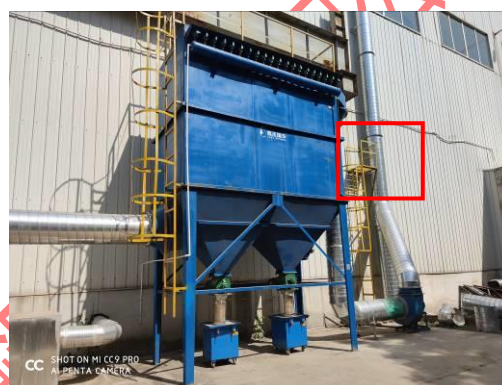
废气处理设施出口监测孔
