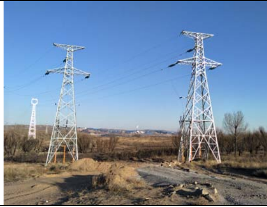
陈越线、苏越线终端塔
