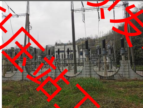
110kV 配电装置区
