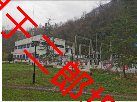
110kV 升压站工程
