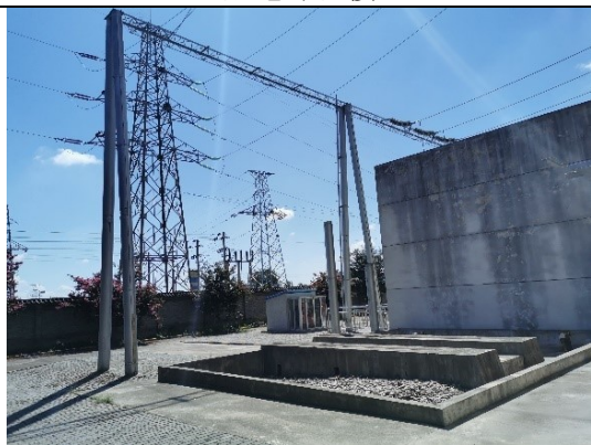
预留 2#主变压器位置
