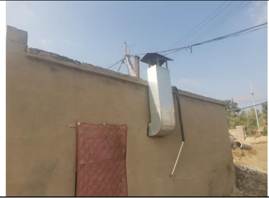
迁建前厂内蒸汽锅炉排气管
